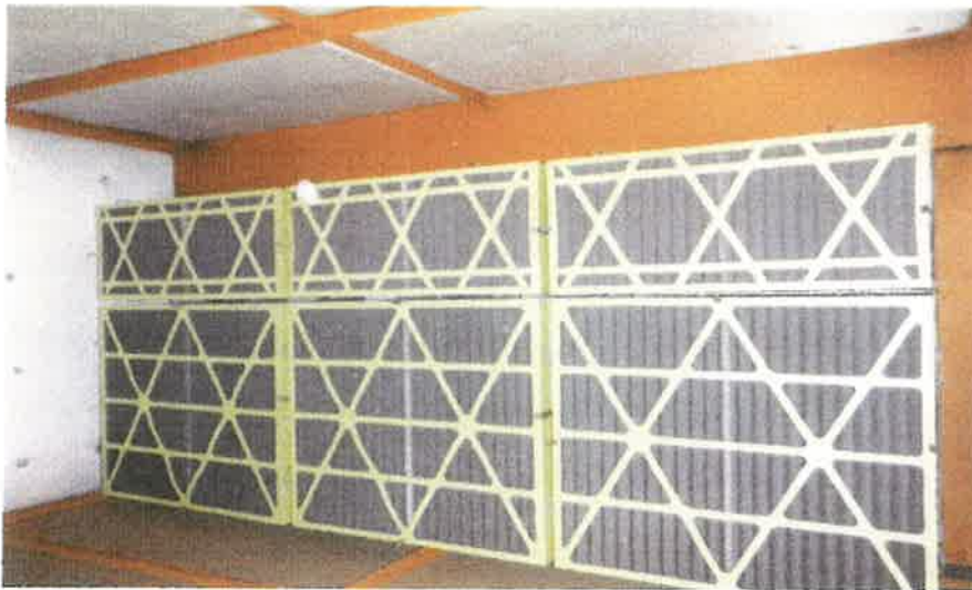
AHU-1 レストラン
