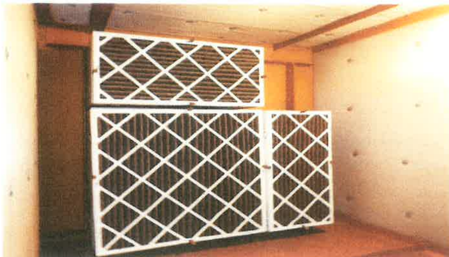
AHU-2,4 実習室・視聴覚室
